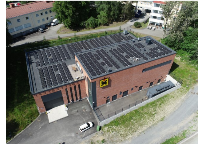
Kuva 9. Kuopion Energian kaukojäähdytyslaitoksen aurinkosähkökenttä (kuva: Essi Holopainen, Kuopion Energia).
