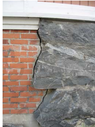
Kuva 20. Kuvassa on vanhan osan nurkan painumisesta aiheutunut halkeama.
