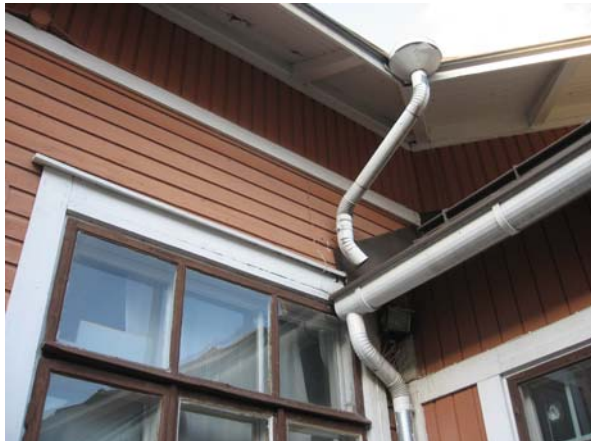
Kuva 25. Kuvassa on syöksytorvi rakenne joka on joskus päässyt vuotamaan ikkunaan ja seinälle.
