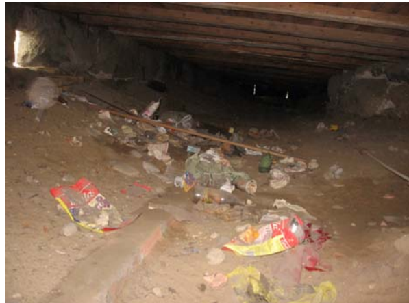
Kuva 16. Uuden osan rossipohjaa ja lasinsiruja sekä roskia joita on työnnetty tuuletusaukosta alapohjaan. Maa-aines on pölykuivaa.
