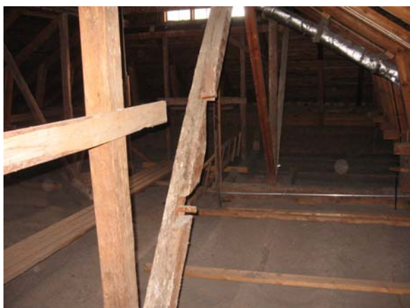
Kuva 35. Kuvassa on uuden osan kantavia rakenteita. Vinotuesta on ilmeisesti joskus poistettu osia. Samanlaisia kohtia oli muutamia.
