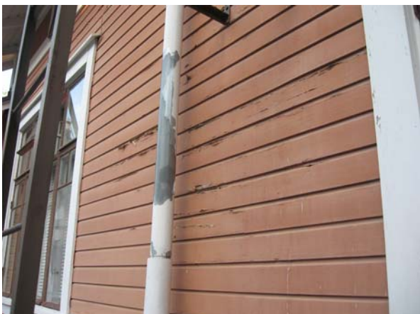
Kuva 24. Kuvassa on toinen julkisivun paneeloinnin vaurioista. Vanha syöksytorvi on vuotanut.
