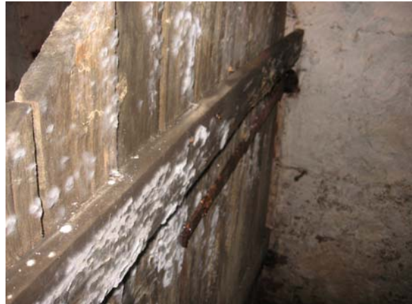
Kuva 8. Kellarikerroksessa olevan puuoven pinnassa on home/sienikasvustoa.
