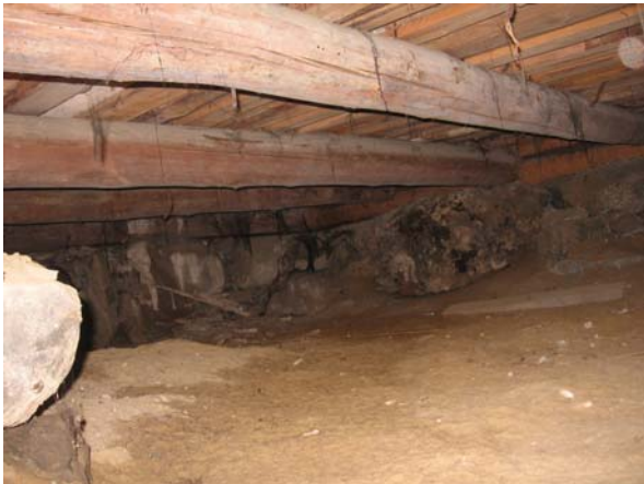
Kuva 15. Kuvassa on vanhan osan rossipohjaa. Vanhan osan ja uuden osan liitoskohta on kuvassa vasemmalla oleva perusmuuri.
