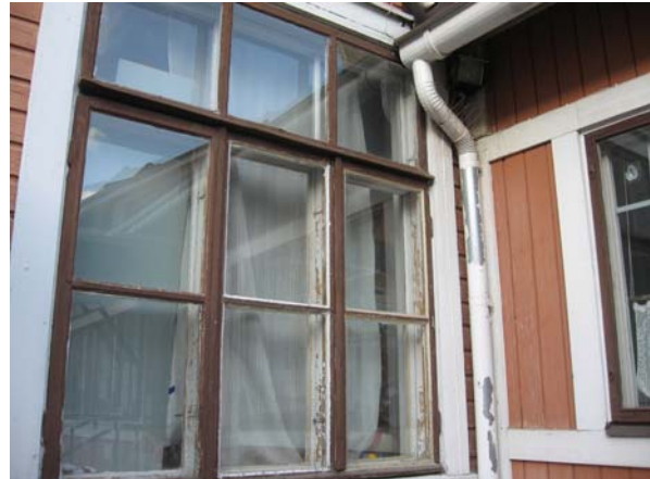
Kuva 26. Vuodosta aiheutuneita vaurioita ikkunnassa.
