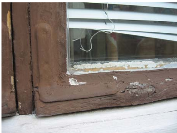
Kuva 29. Kuvassa näkyy ikkunan puuosien vaurioita.
