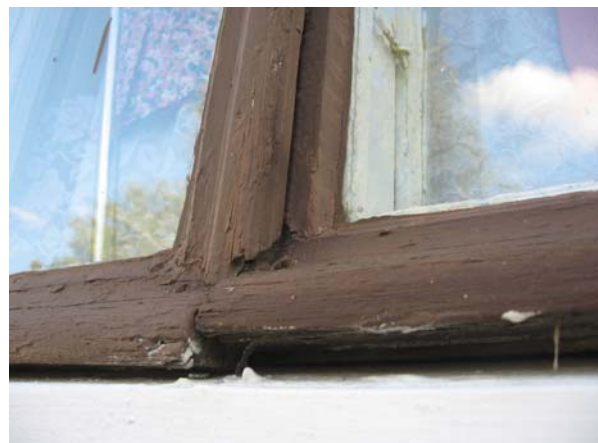
Kuva 30. Kuvassa näkyy ikkunan puuosien vaurioita.
