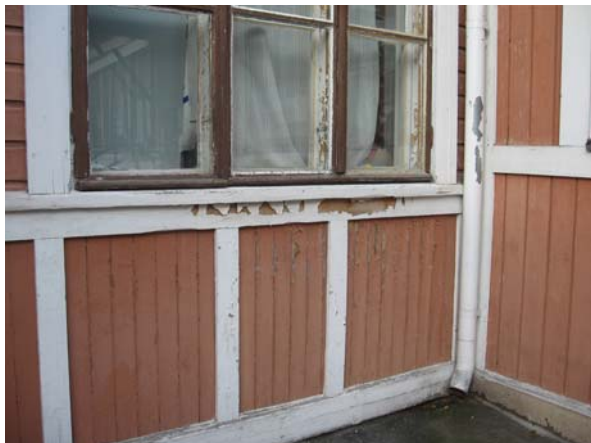
Kuva 27. Kuvassa vuodosta aiheutuneita vaurioita seinän paneeloinnissa.
