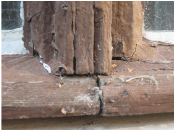
Kuva 31. Kuvassa näkyy ikkunan puuosien vaurioita.
