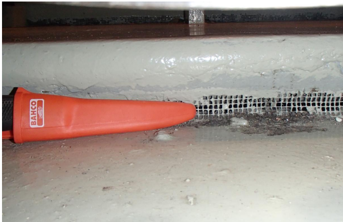
Kuva 24. Kuva raosta tuolirivistöjen alla.
