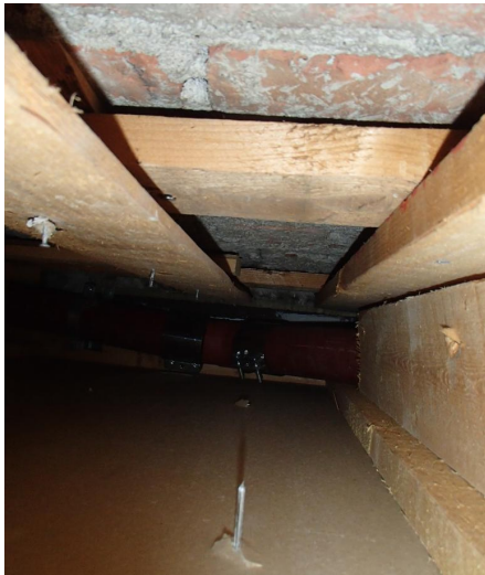
Kuva 21. Kuva kotelon sisältä.
