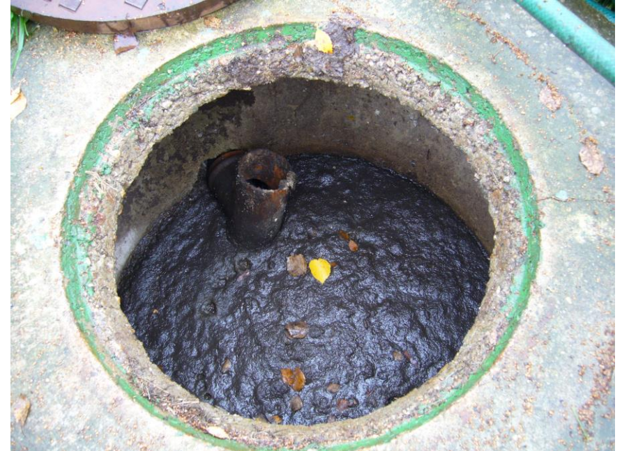
Kuva 6. Jätevesijärjestelmät pysyvät kunnossa sakokaivojen säännöllisellä tyhjennyksellä. Tämä kaivo kaipaa pikaista tyhjennystä.
