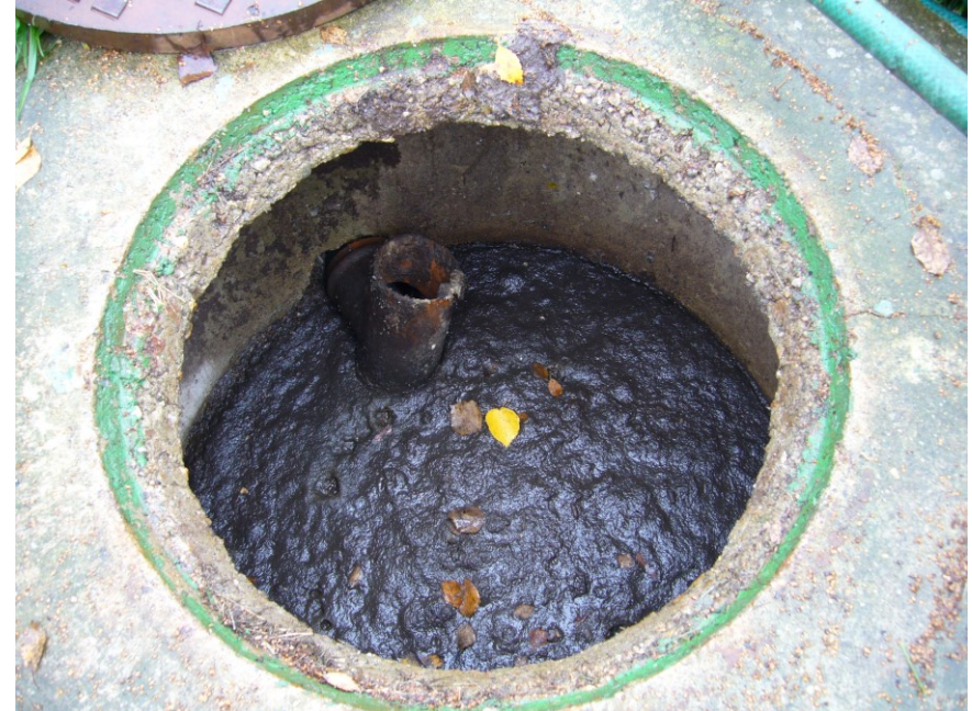
Kuva 7. Jätevesijärjestelmät pysyvät kunnossa sakokaivojen säännöllisellä tyhjennyksellä. Tämä kaivo kaipaa pikaista tyhjennystä.
